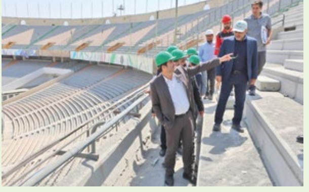
در این جلسه بر بازسازی استخر آزادی و استادیوم ۱۲ هزار نفری تأکید کرد و اینکه در کنار بازسازی ورزشگاه فوتبال این دو مجموعه نیز عملیات مختلف درحال بازسازی ورزشگاه آزادی بازدید کرد.
