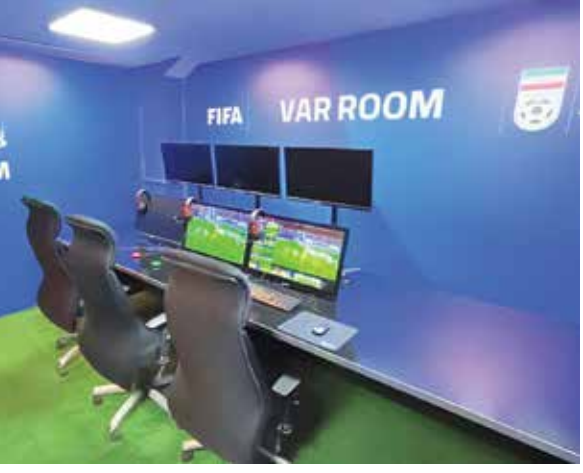
افزود: «طبق قوانین جاری فیفا بازی شبیه‌سازی شده‌ای را برگزار کردیم که طی آن داوران لیگ، عضو کارگروه نظام رفاک تجهیز، نصب و راه‌اندازی سیستم کمک‌داور ویدیویی فدراسیون فوتبال، در خصوص نصب و راه‌اندازی محموله سیستم داور ویدیویی در ورزشگاه امام خمینی (ره) شهر اراک گفت: «خوشبختانه دستگاه به طور کامل در ورزشگاه نصب و راه‌اندازی شد و تست‌های مربوطه را انجام دادیم که موفقیت‌آمیز بود.»
